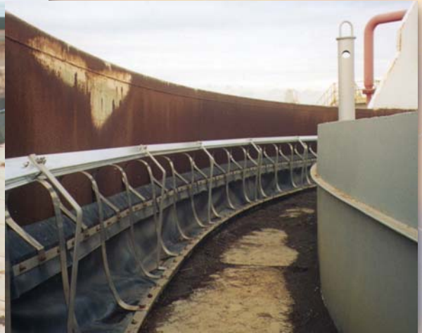
Sistema Antincendio Serbatoi a tetto galleggiante
